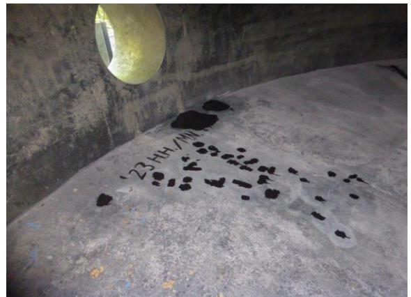
Abbildung 6, Innenbeschichtung geleerter Faulturm, Quelle: ZSA Pfannenstiel
