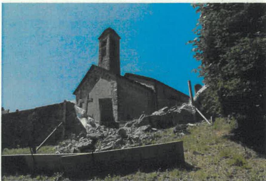
Figura 3: Situazione attuale a valle del muro ceduto
