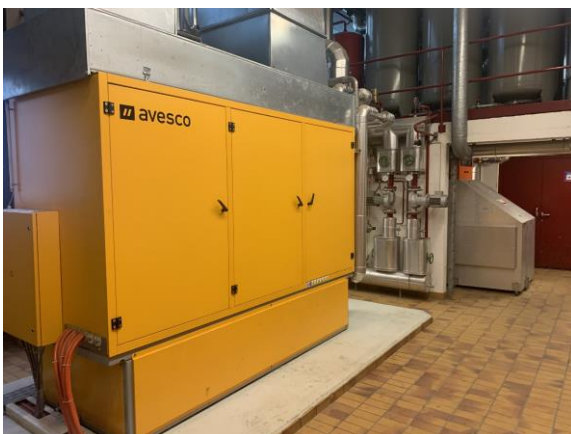
BHKW aus dem Jahr 2007 mit über 100'000 Betriebsstunden
