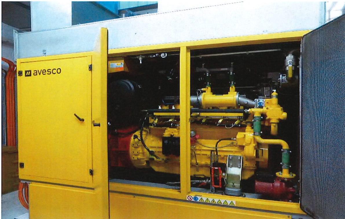
BHKW aus dem Jahr 2007 mit über 115'500 Betriebsstunden
