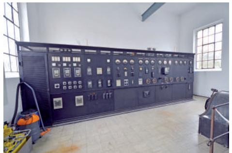
Bild 12: Alte Schalttafel als Museumsstück
