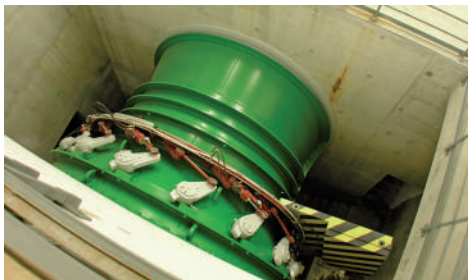
Bild 6: Leitapparat zu Kaplan-S-Rohrturbine
