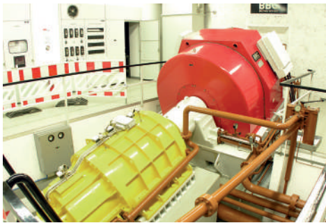
Bild 4: BBC-Generator zu Kaplan-S-Rohrturbine
