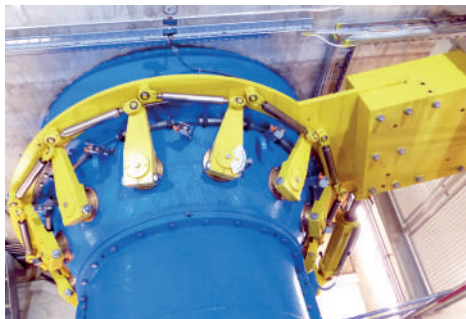
Bild 15: Leitapparat mit Schliessgewicht Dotier-KW
