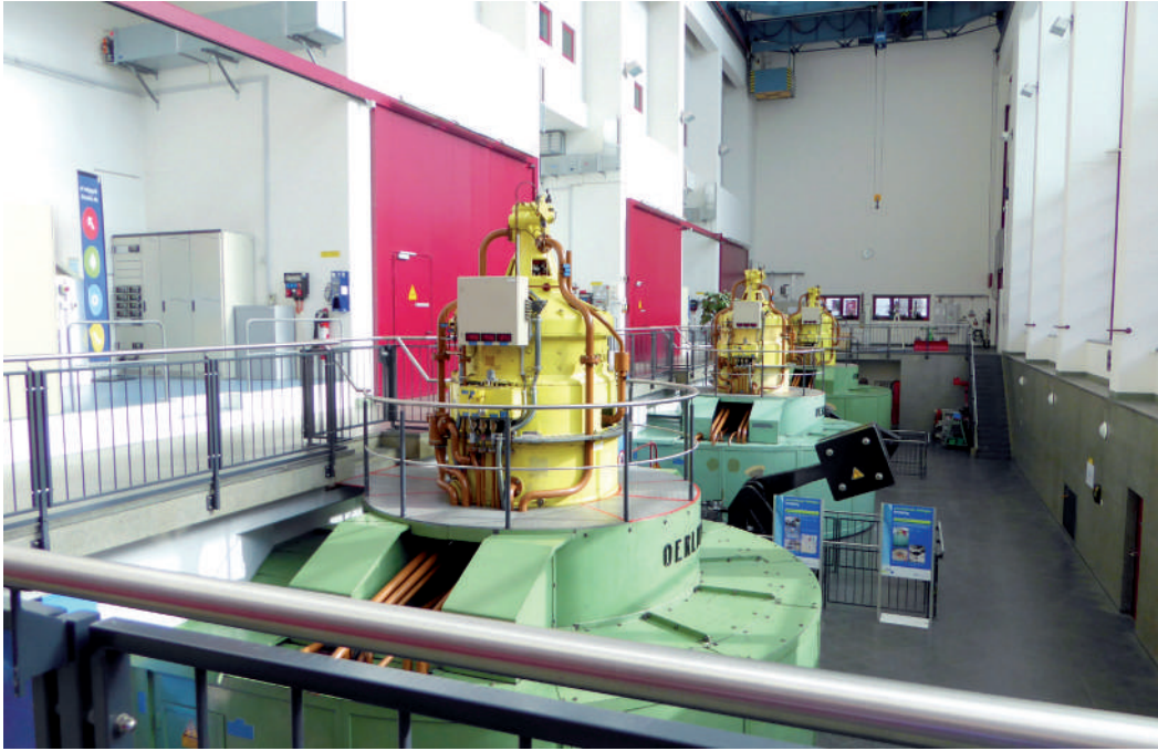
Bild 17: Maschinensaal mit 3 Escher-Wyss Vertikal-Kaplanturbinen
