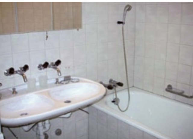
Vor den Renovationsarbeiten lud das Bad von Simone Bischofberger-Gumpp nicht zum Verweilen ein.
