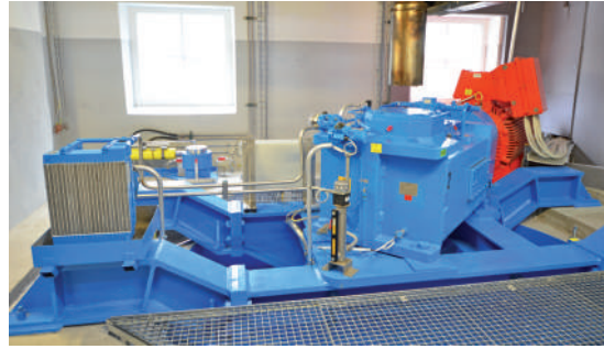
Bild 28: Maschinengruppe 2 mit Francis-Turbine und Generator
