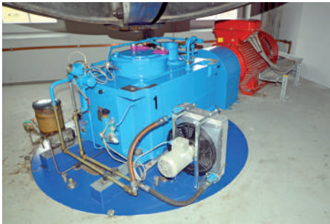
Bild 27: Maschinengruppe 1 mit Francis-Turbine und Generator
