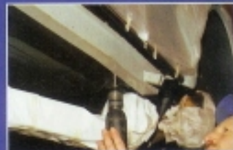
Wie wichtig eine Ablaufbohrung im vorderen Bereich des Cabrio-Schwellers ist, ...
