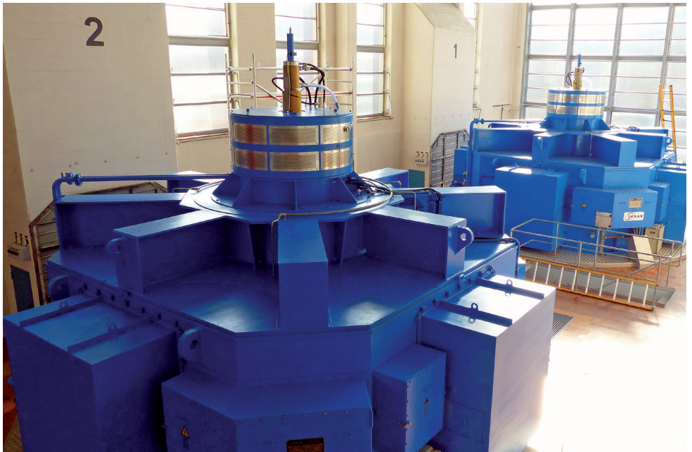
Bild 5: Die zwei Kaplan-Turbinen im KW Letten
