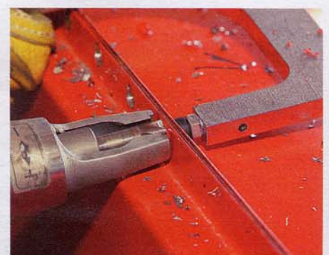
Mit dem Schälbohrer trennt Thomas Geis nur die oberste Blechlage auf. Dann lässt sich...
