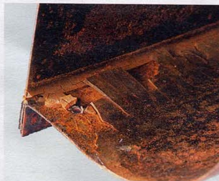
Fertans neues Nanoprodukt NT10 lagerte sich am Schwellerboden ab und bildete Risse
