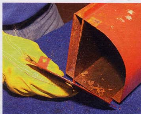
Schon beim Abnehmen der ehemals blanken Seitendeckel wartet die braune Pracht
