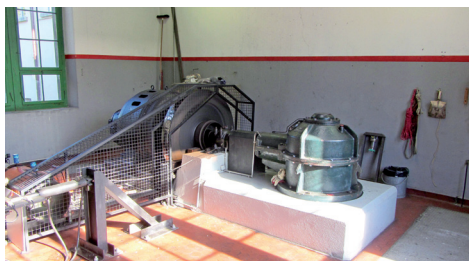
Bild 9: KW Oederlin Maschinengruppe 1.2 mit Kaplanturbine und BBC Generator
