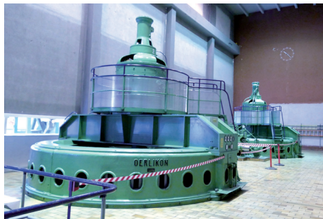
Bild 10: Maschinenraum 2017 mit zwei Kaplan-turbinen mit Oerlikon Generatoren Baujahr 1933
