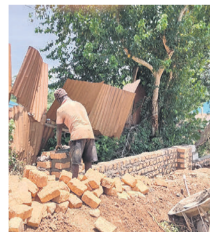
Ein Sturm hat die Umzäunung beschädigt, diese muss jetzt ersetzt werden.
