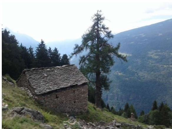
Vista da Sud con tetto in cattivo stato
