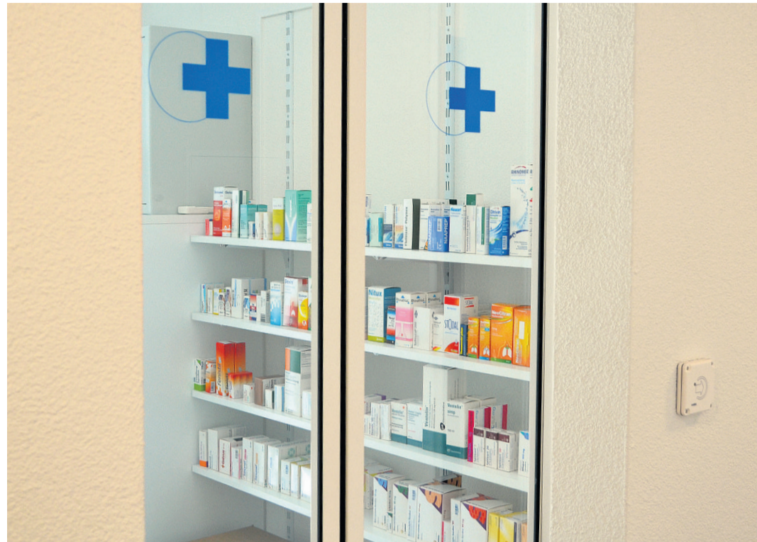
Die neue Apotheke verfügt über ein Sicherheits- und Zutrittsystem mit Badge und wird klimatisiert.
