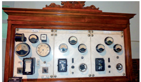
Bild 5: Schalttableau 1899 der Generatoren für die Jonval- und Francisturbinen
