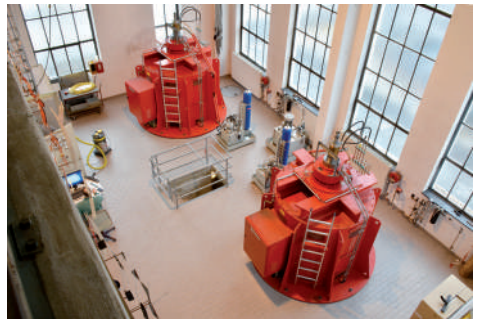
Bild 9: Die neuen Maschinengruppen im Kraftwerk
