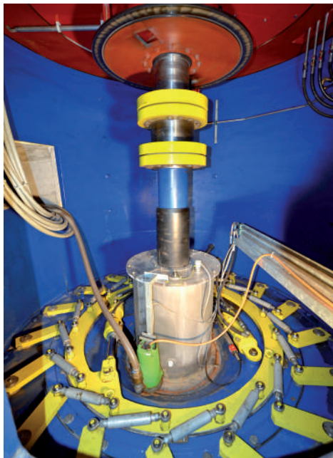
Bild 10: Leitapparat zur Kaplan turbine
