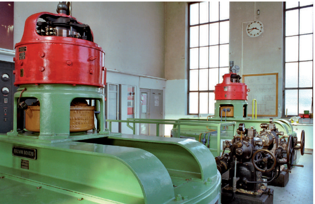
Bild 4: Die zwei Maschinengruppen mit Charnilles-Kaplanturbinen und BBC Generatoren 1934 bis 2000 in Betrieb
