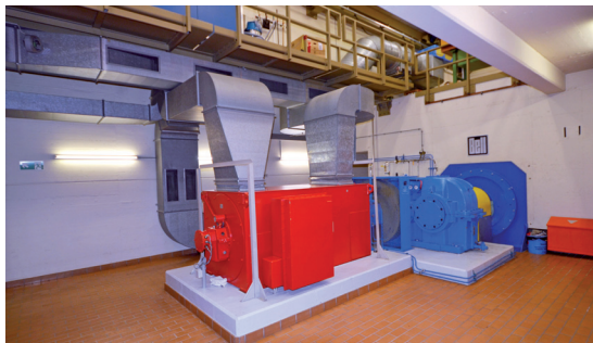
Bild 11: Generator zur Kaplan-S-Rohrturbine 2018
